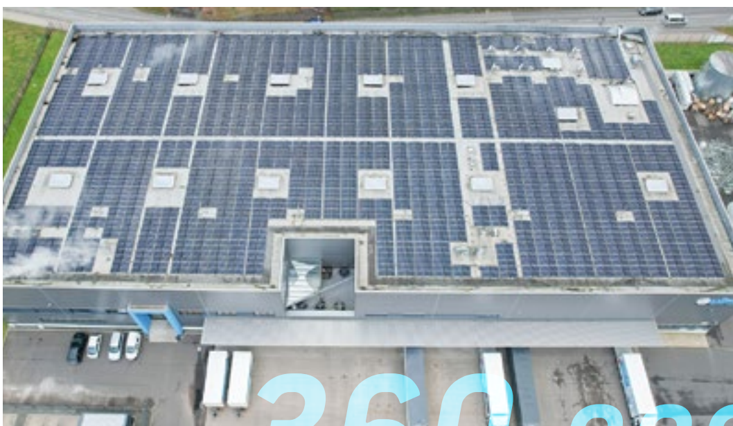
PV-Anlage am Standort Schmalkalden
